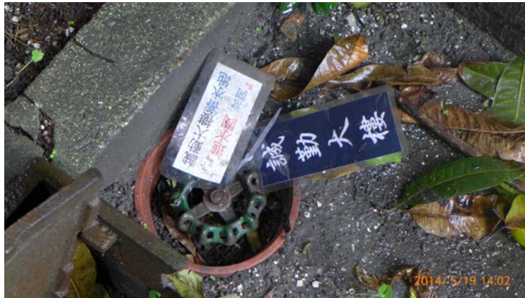
圖三 誠勤大樓進水閥門
