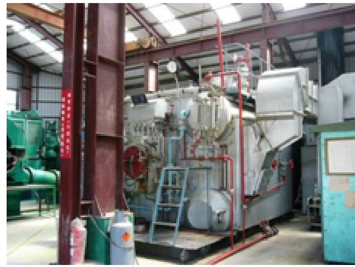
備註：水管式鍋爐。
