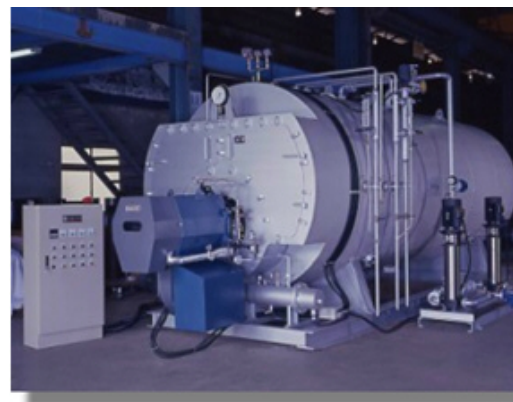
備註：臥型煙管式鍋爐。
